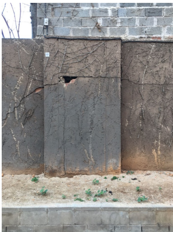
Imagen de la grieta de la calle de Concili de Trento, 5
